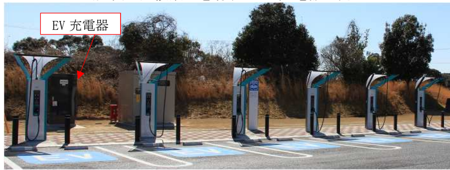
(図表 3) 複数口を有する EV 充電器の例
